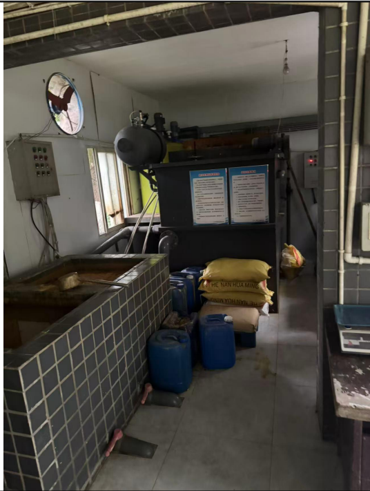
废水处理设施及标识牌
