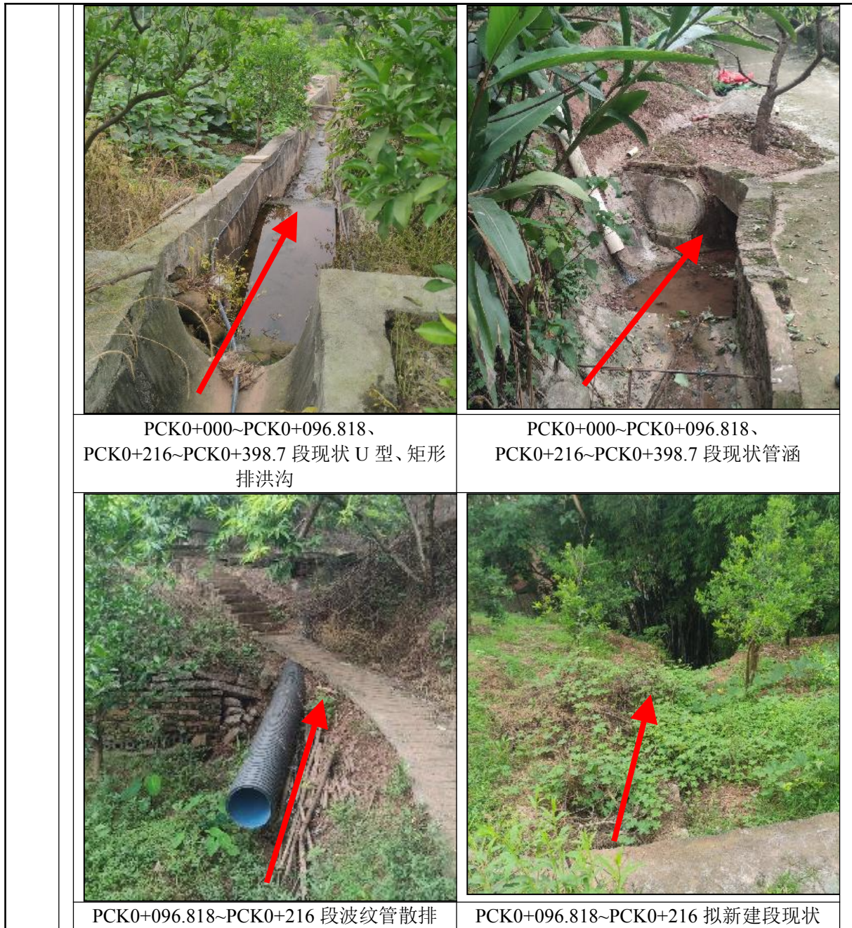
图 2-14 排洪沟 C 现状图
